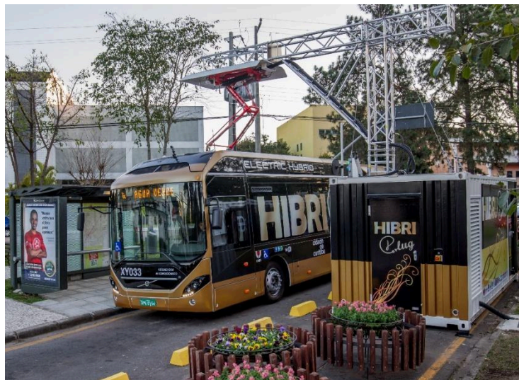
Figura 4: Estação de Recarga
